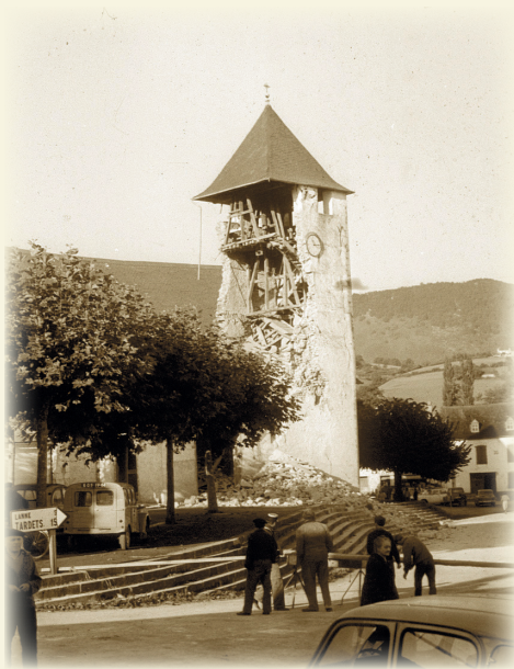
13 août 1967 : le clocher de l'église d'Arette après le séisme. (archives communales d'Arette)
